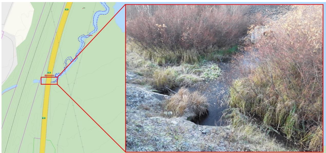
Figur 2-18: Stikkrenner gjennom E6. Sett fra E6 og oppover.
